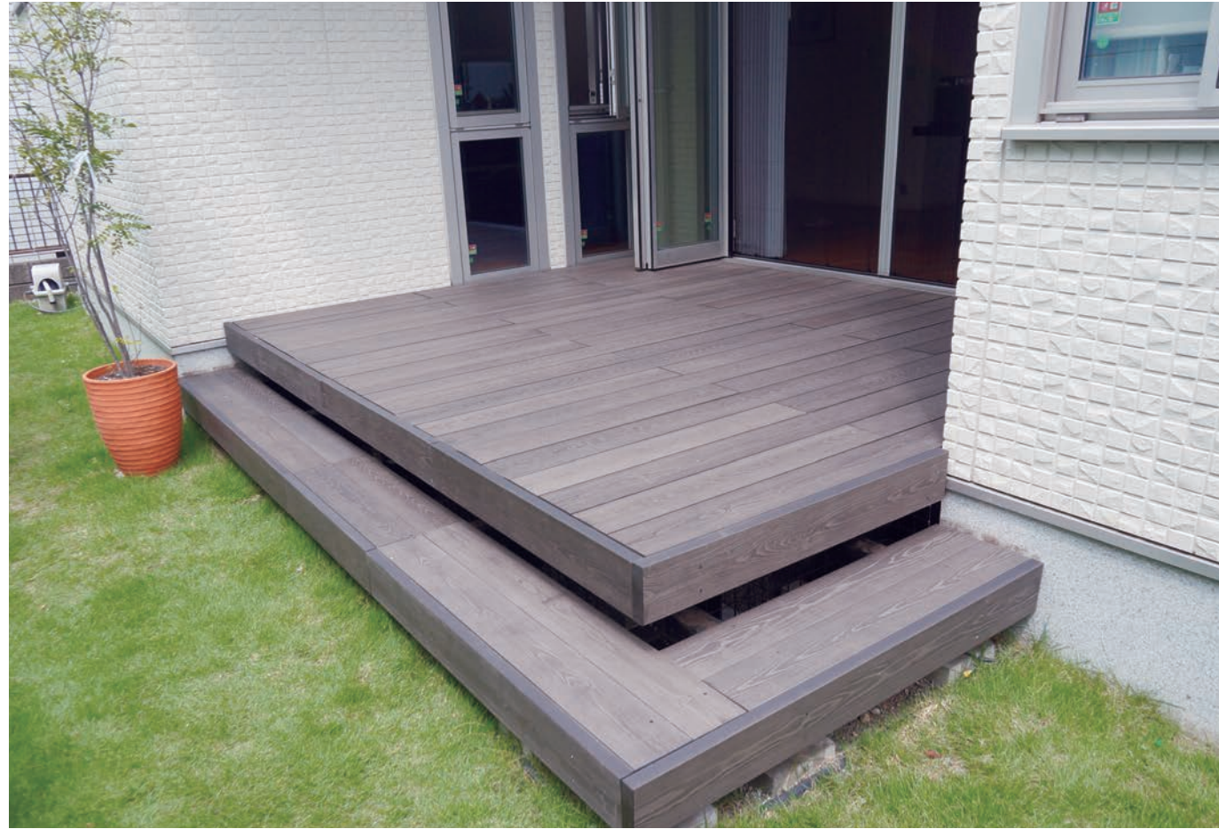
反ってしまった人工木デッキのリフォームに 土台を活かした施工も可能
